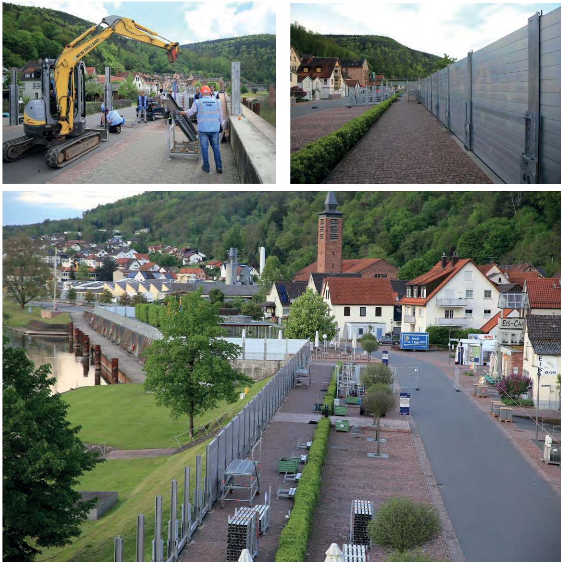
Abbildung 79: Hochwasserschutzmaßnahmen am Main
